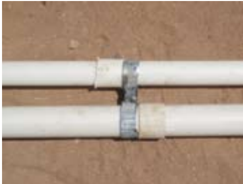
FIGURA 34. BRAÇADEIRAS UNINDO OS TUBOS DE IMPULSAÇÃO E RETORNO
